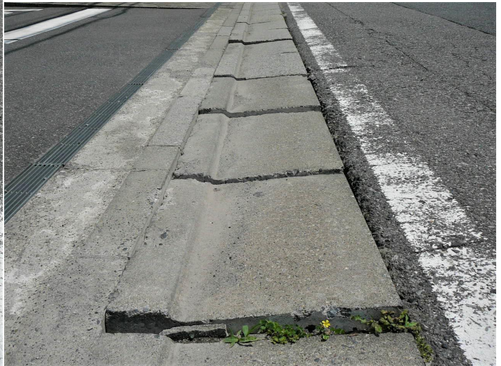
側溝の蓋の写真: 2022年5月19日撮影
