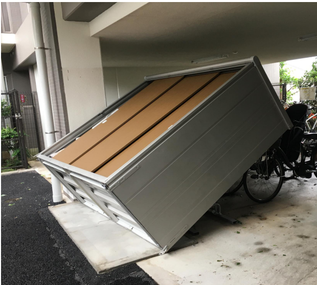
一部倒壊した倉庫は、一時的に壁の横に退避→
